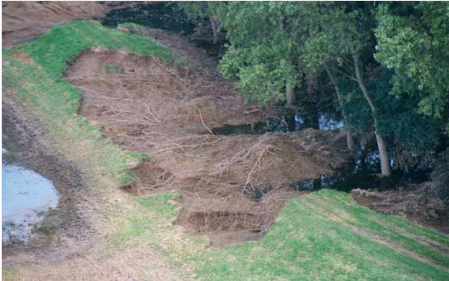
Bei Hochwasser freigelegte Durchwurzlung eines Deiches
